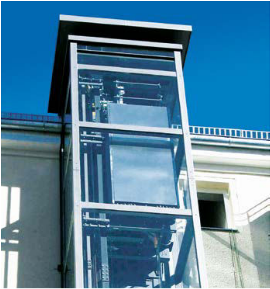
Úhelníková konstrukce šachty Úhel otevřen dovnitř
