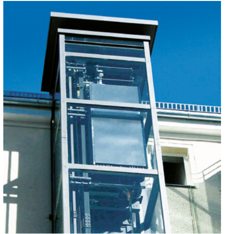
Úhelníková konstrukce šachty Úhel otevřen dovnitř
